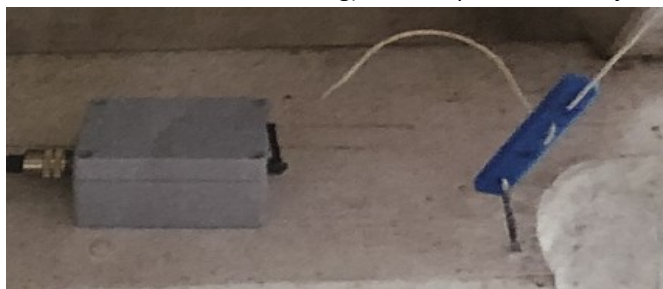
De trafo en het begin van de antenne onder de dakoverstek bij DK4FD
